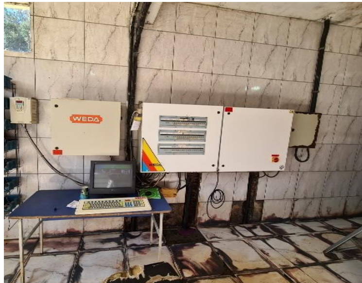
Figura 8: painel de comando
